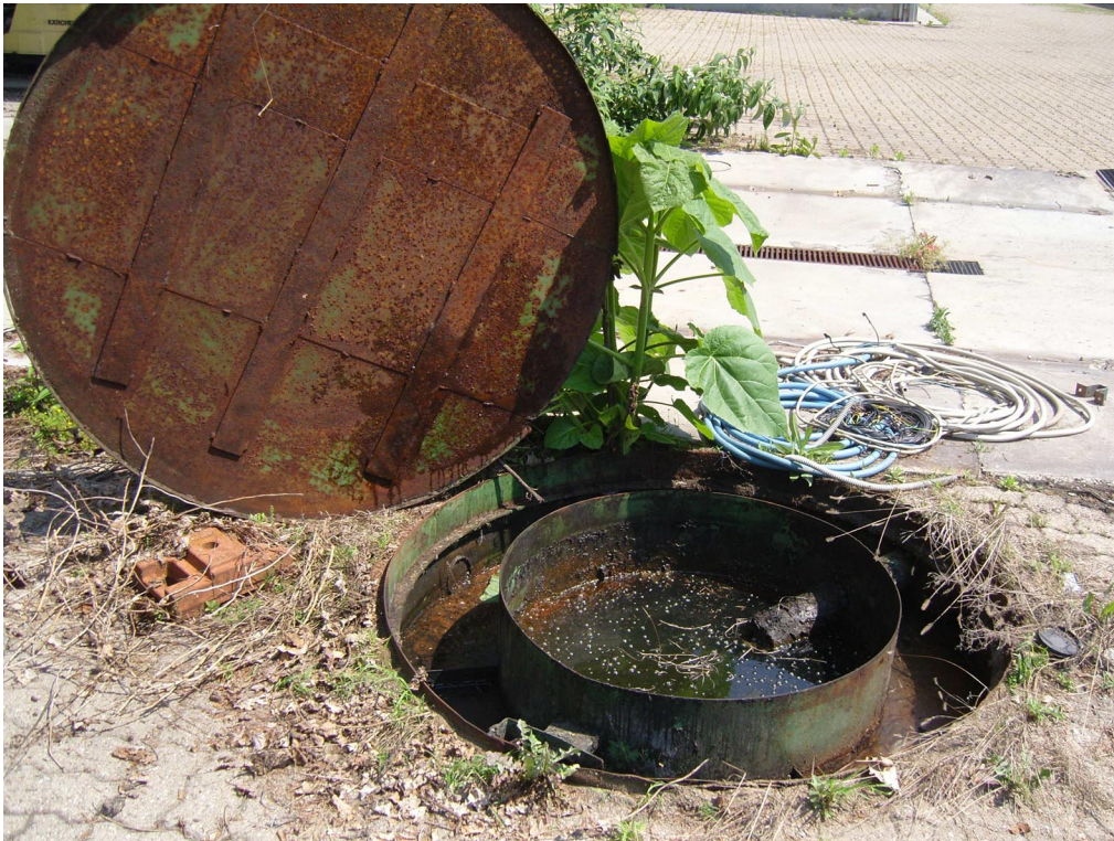
Foto 12: pozzetto disoleatore adiacente l'area dell'autolavaggio.
