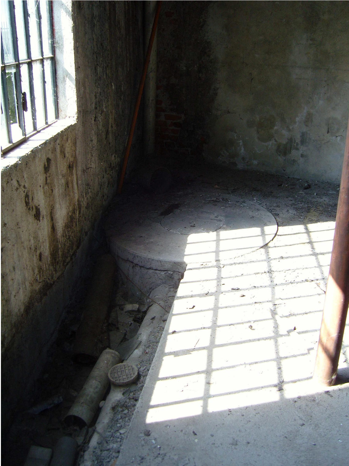
Foto 8: fossa settica tipo Imhoff nel Fabbricato C.
