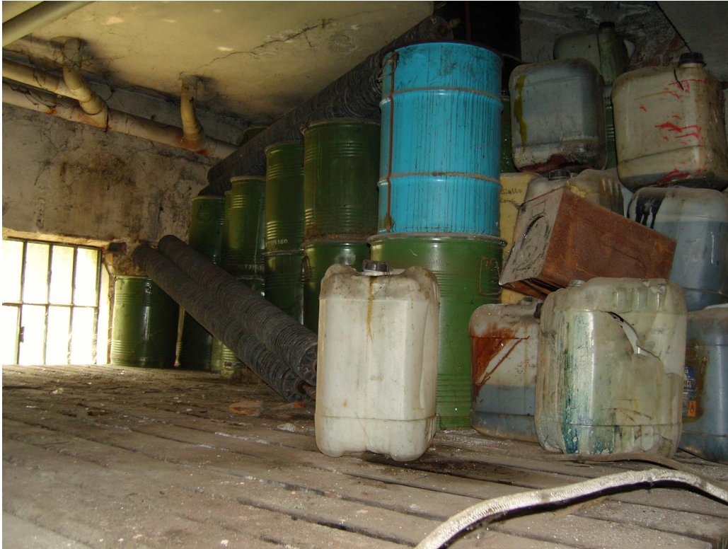
Foto 14: soppalco ammalorato ubicato sopra la fossa Imhoff, con accumulo di fusti inquinati da smaltire.
